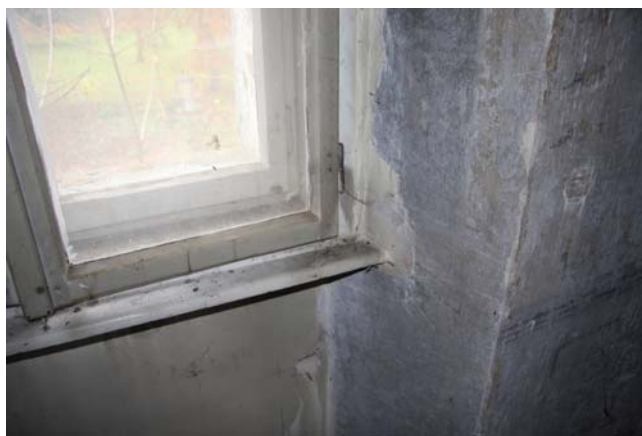
Napačna vgradnja škatlastega okna v špaleta z poškodbami poslikav
