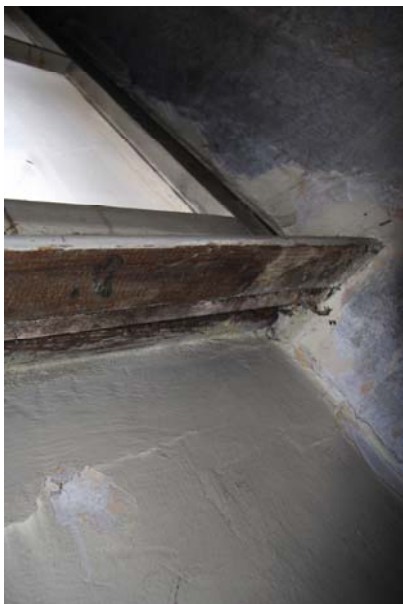
Škatlasto okno z spodnje strani okno je v zraku in ne opravlja funkcijo toplotne izolativnosti
